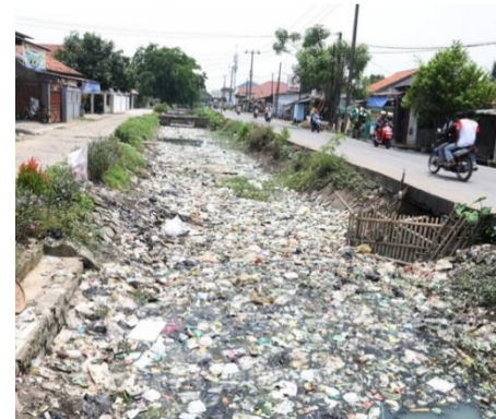
Penumpukan sampah pada saluran irigasi Jalan Rawa Rengas, Kosambi, Kab Tangerang
